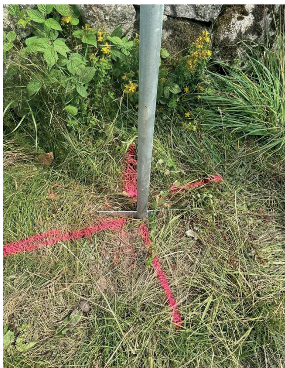
Montage av stolpe i markerat kryss, c/c 4 meter, +/- 15 cm beroende på terräng
