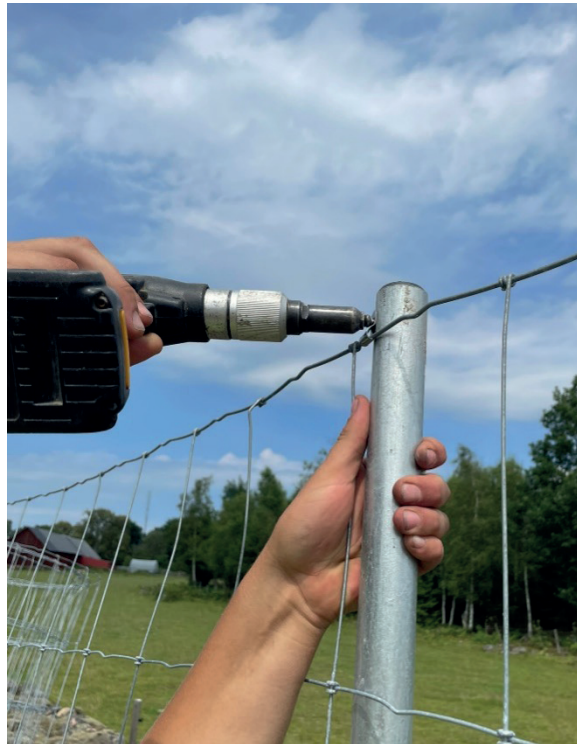
Montage av nät på stolpe med pop och bläck, i förborrade hål, höjd 220 cm över mark, +/- 10 cm beroende på terräng
